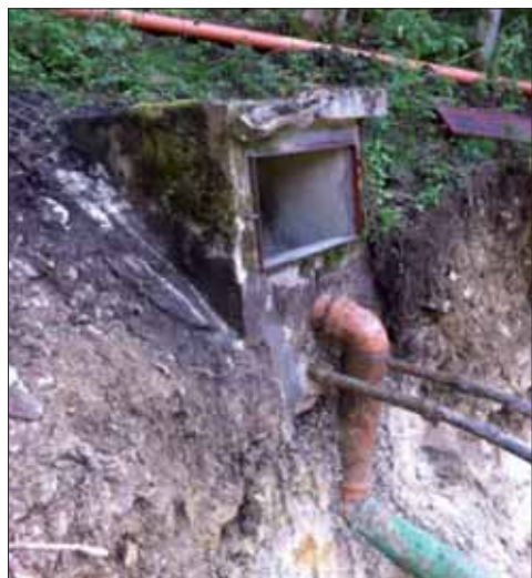
Ancien puits avec 2 départs alimentant les fontaines et un trop-plein
